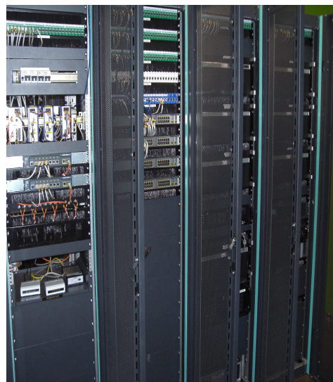
Baie informatique équipée de switches, serveurs, répartiteurs réseaux. La salle informatique dispose de 4 baies de ce type.
