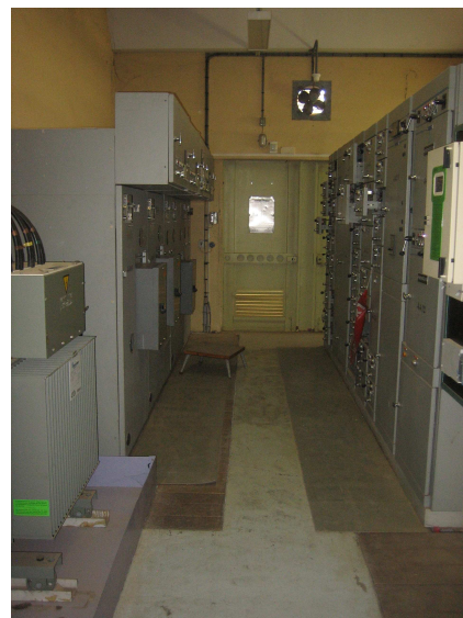
Installations électriques existantes sur la station de pompage d'eau potable du Ventillon.
