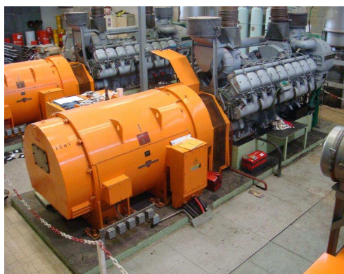
Groupes électrogènes existants sur la station de pompage d'eau brute de Vigueirat
